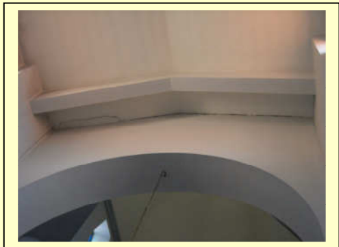
FOTO 13) Frattura passante tra presbiterio e navata
