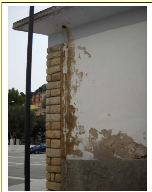
FOTO 14) Effetti sulla muratura della mancanza di discendenti per la raccolta delle acque piovane
